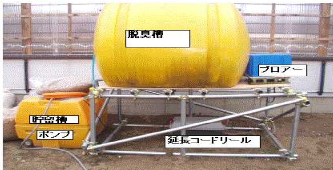
図2 ガラス発泡材脱臭装置の設置状況
